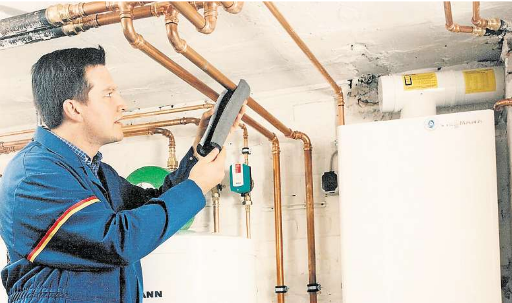
Kupfer bewährt sich seit vielen Jahrzehnten in der Hausinstallation und ist auch bei Modernisierungen eine wertbeständige Investition. Foto: DJD/Kupferverband
