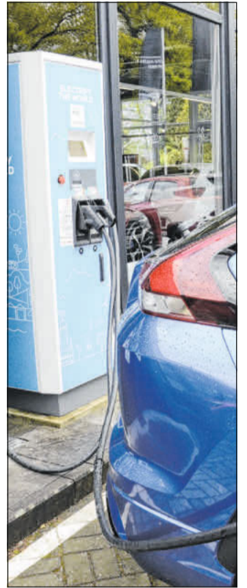
Am Standort an der Hannoverschen Heerstraße ist im Jahr 2023 eine Schnellladesäule in Betrieb genommen worden. Foto: Müller
